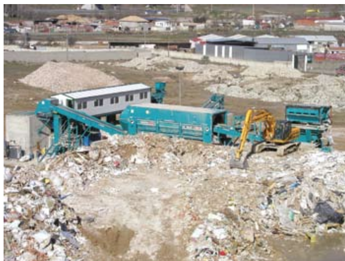
Figura 2. Planta de reciclaje. Figure 2. Recycling plant.
