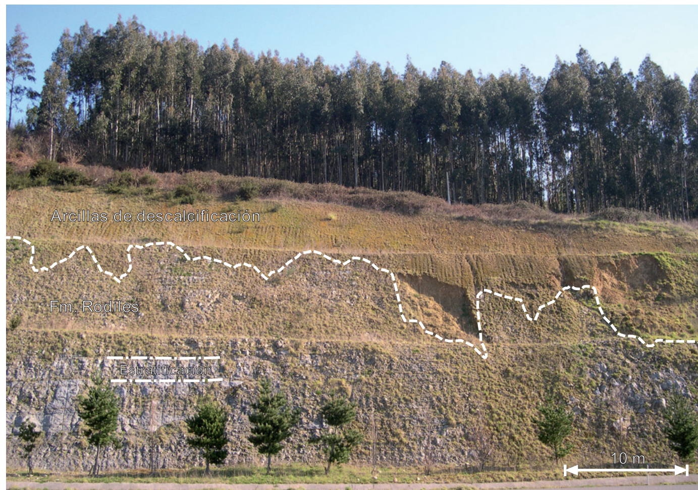
Figura 2. Talud en la Autovía A-8 (km 351) en el que se aprecia el contacto entre la ritmita del sustrato rocoso (calizas y margas del Jurásico Inferior) y las arcillas de alteración.
